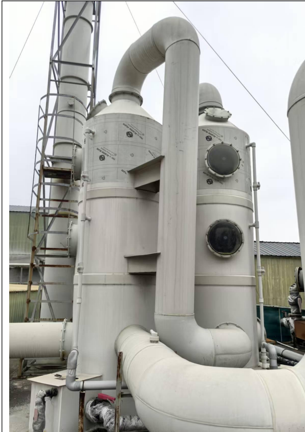
两级喷淋塔（水+氢氧化钠溶液）
