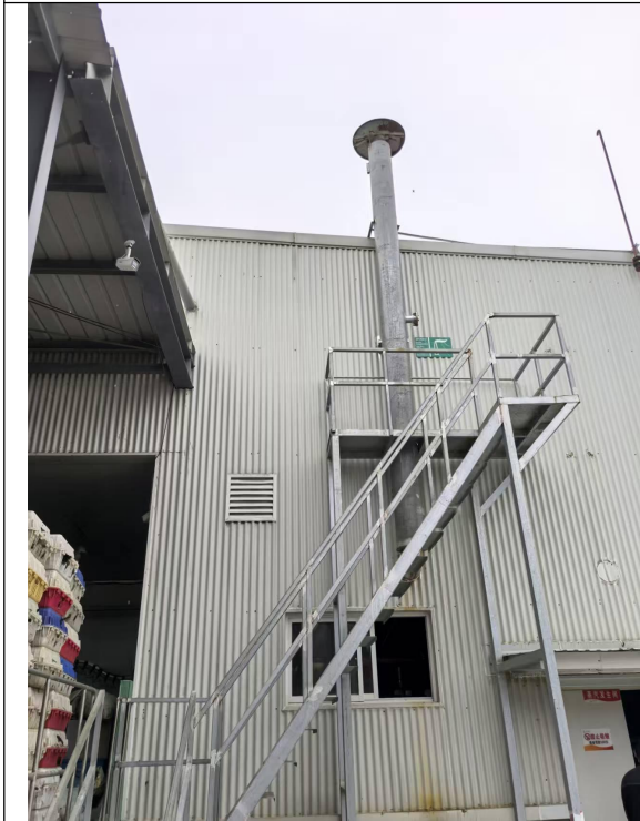
天然气锅炉排气筒
