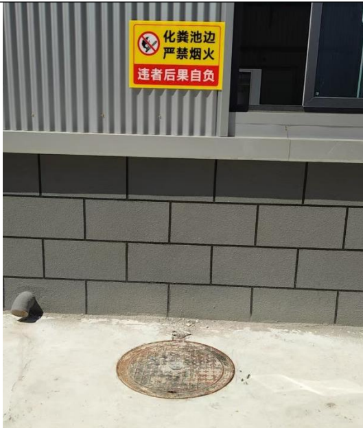
废水处理设施1：化粪池
