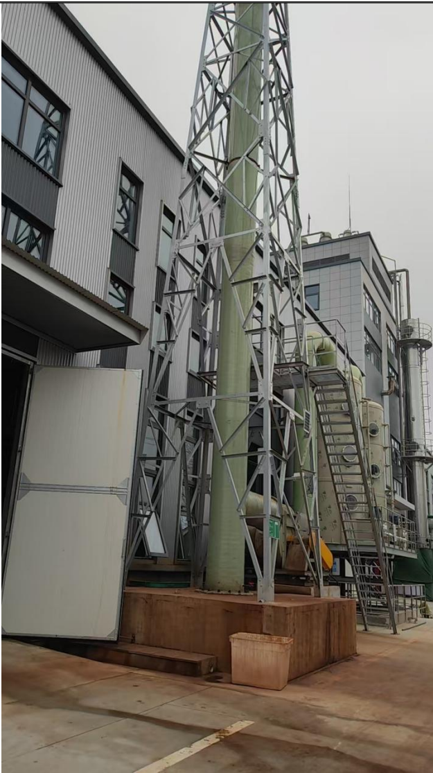
工艺废气（浸泡、切碎、发泡沉降、钙化、脱钙、液相转化、脱水、蒸馏）、储罐废气处理设施：二级水喷淋+二级活性炭
