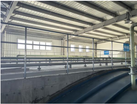
废水处理设施2：HAR厌氧池+中间水池
