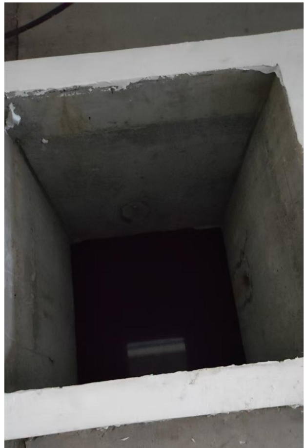
废水处理设施3：浮选池
