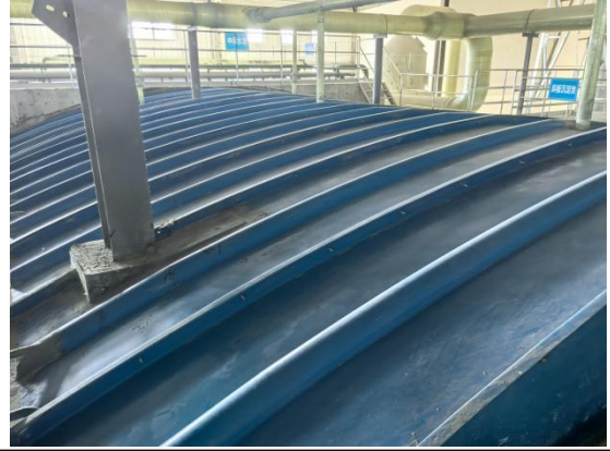
废水处理设施2：絮凝沉淀池
