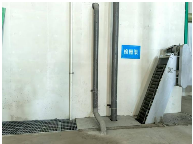
废水处理设施2：格栅
