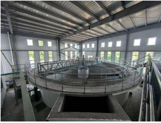
废水处理设施2：二沉池
