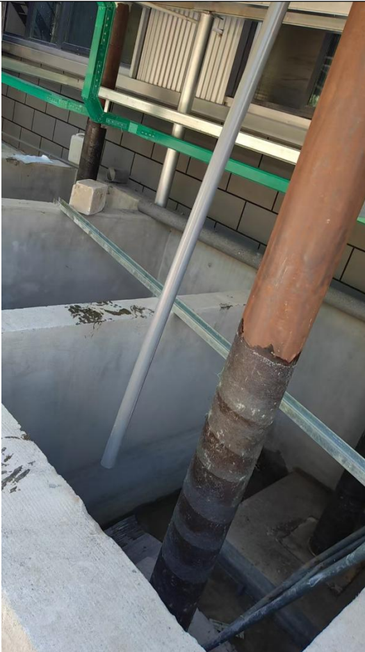
废水处理设施3：漂浮池
