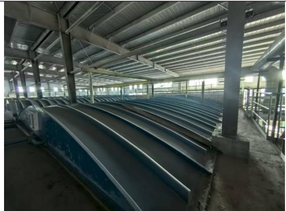
废水处理设施2：好氧池
