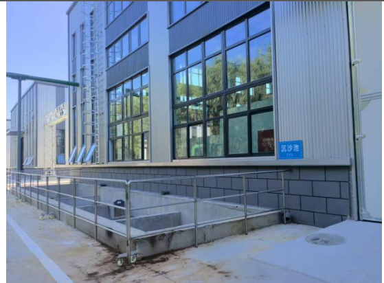
废水处理设施2：预处理沉淀池
