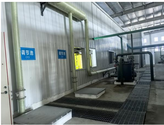
废水处理设施2：调节池
